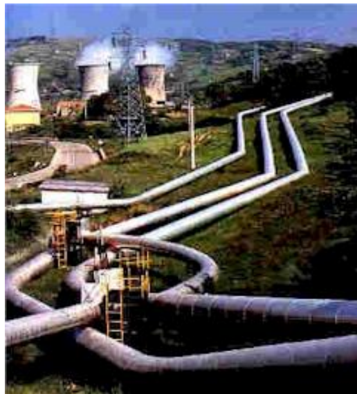
Fig. 10.11 Central Geotérmica en Nueva Zelanda
