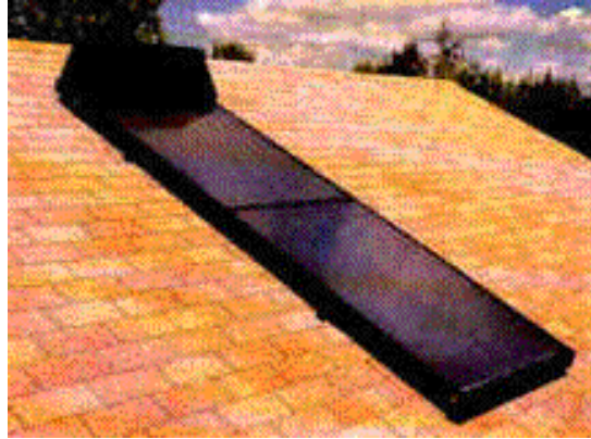
Fig. 10.5 Colectores de baja temperatura
